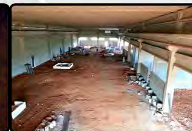
Visão geral do salão principal do Laboratório de Aerodinâmica e Hipersônica Henry T. Nagamatsu à época da construção (2013).
